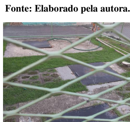
Figura 17 - Caixa subterrânea de água da chuva do Condomínio Riviera Maia
