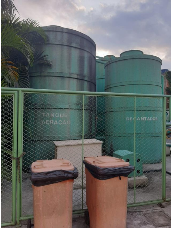
Figura 14 - Estação de tratamento de esgoto do Condomínio Riviera Maia
