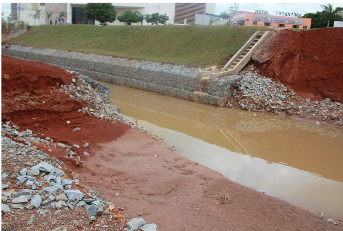
Foto 38 Rio das Antas no Bairro Andracel. Início de obra de contenção Foto: Autora(2013)
