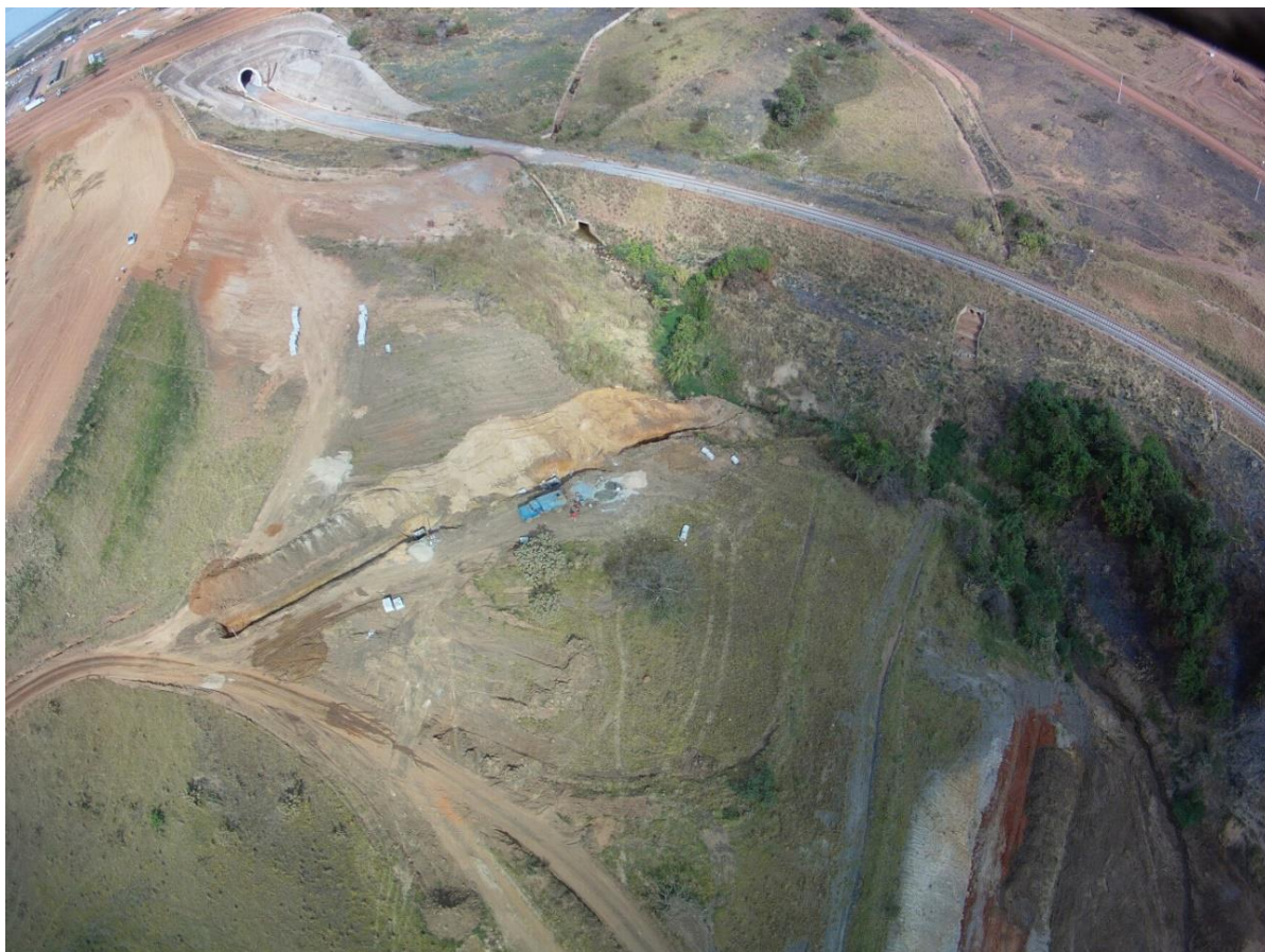
Foto 6 Túnel sob BR 153, a via férrea e áreas de nascentes do Rio das Antas Foto aérea: (Potenciano, 2013)
