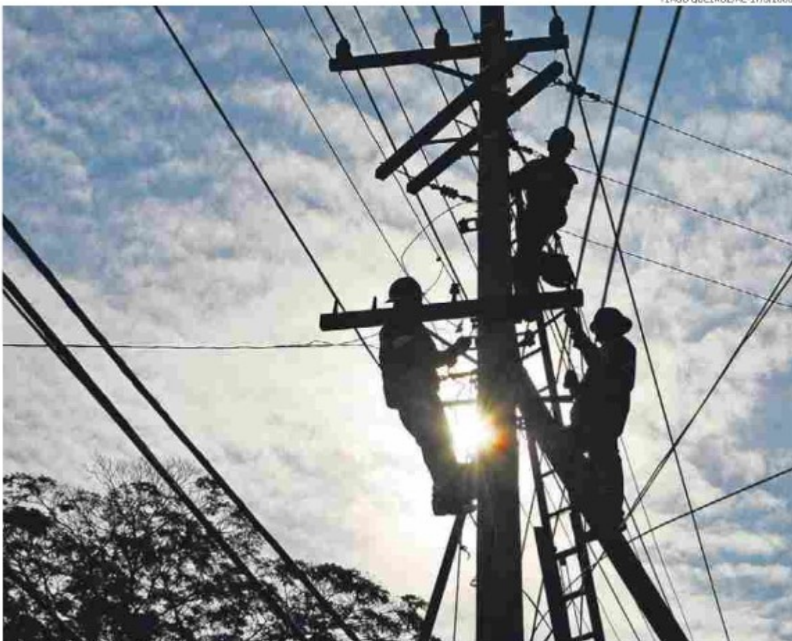
Despesa. AES Eletropaulo gastou R$ 16,9 milhões por causa dos apagões do 1º semestre
